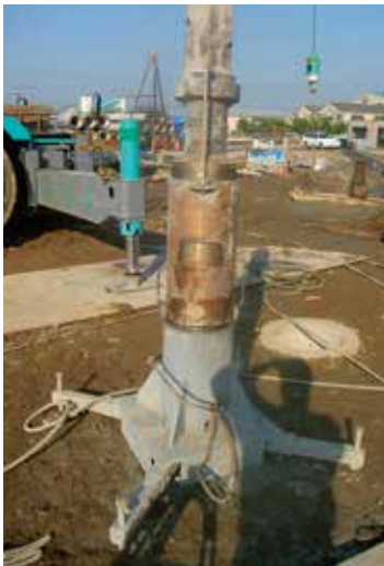
外管閉塞状態
